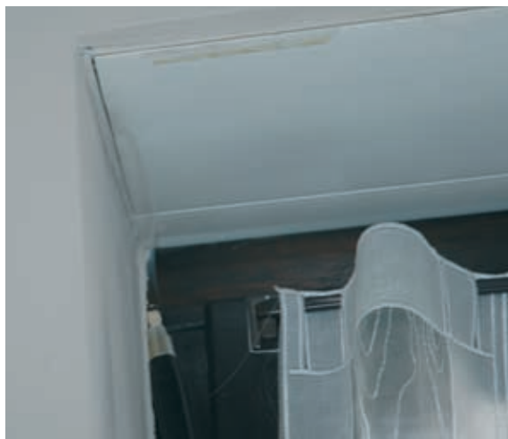
Fot. 5. Nieszczelność w kasecie rolety zewnętrznej po wewnętrznej stronie okna
